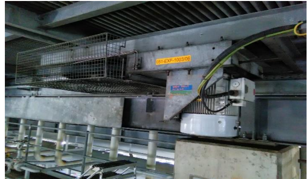
Gambar 1. Air Fan Cooler
