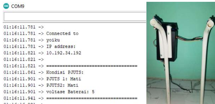
Gambar 18 Status koneksi webserver pada arduino IDE (kiri) dan kondisi lampu (kanan)
