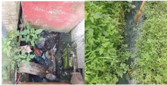
Gambar X. Kondisi Eksisting Saluran Drainase Dipenuhi Sampah, Rumput serta Sedimen (Sumber : Dokumentasi Penelitian, 2025)
