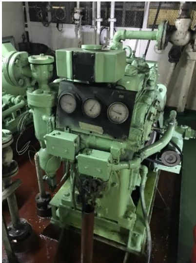
Gambar 9. Pressure kembali normal pada Kompresor udara
